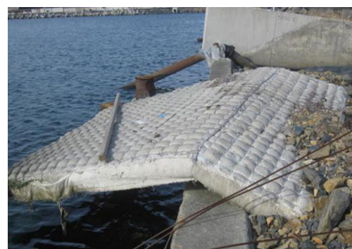
写真-1 東日本大震災 津波被災事例
