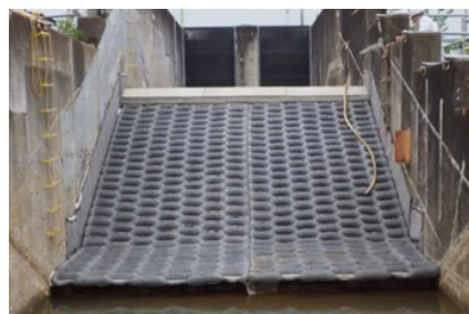
写真-15 ケース 2 越水実験後状況
