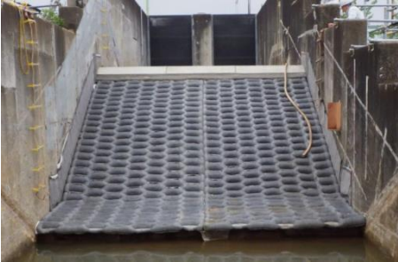
図-8 越水実験後状況（越水後）
